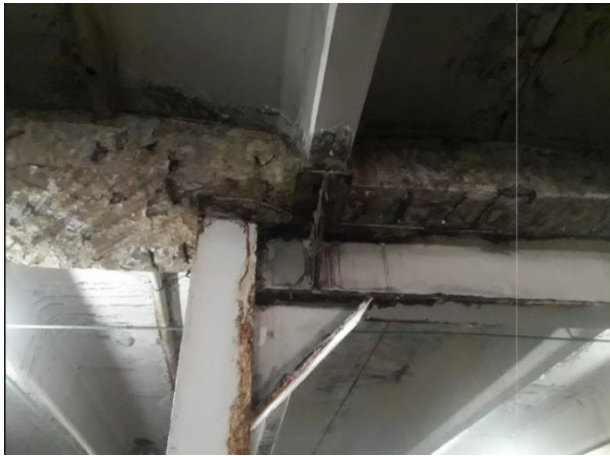
Imagen 19: Foto tomada en campo en el mes de febrero de 2022 en el sótano de la Plaza José María González Arratia, en el que se muestran los daños estructurales.
